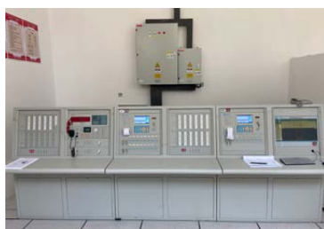
微型消防室控制台
