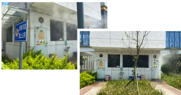
危险化学品仓库汽化降温现场
